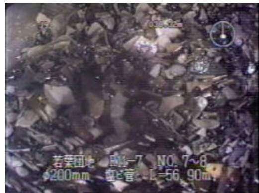
図 3.4 管渠内堆積物拡大（平成12年8月）
