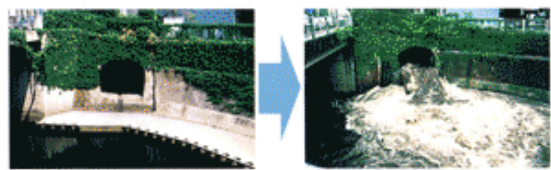
雨水吐からの未処理下水の放流状況
