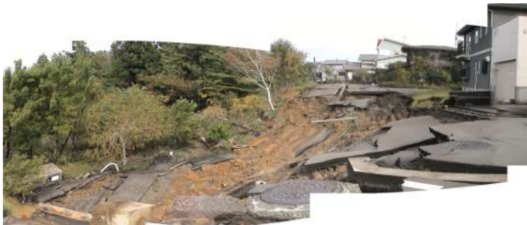
写真二 新潟県中越地震における盛土の滑動崩落の被災事例（長岡市高町団地地区）
