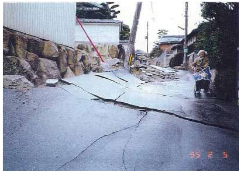
写真一 阪神・淡路大震災における盛土の滑動崩落による被災事例（兵庫県提供資料）
