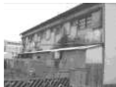
老朽木造アパート
