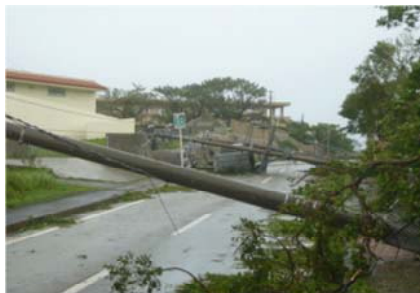
【台風により電柱が倒壊した事例】
