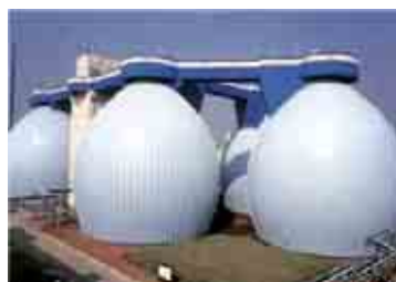
下水汚泥からメタンを回収する消化タンク
