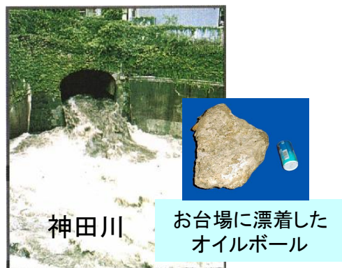
未処理下水の放流状況
