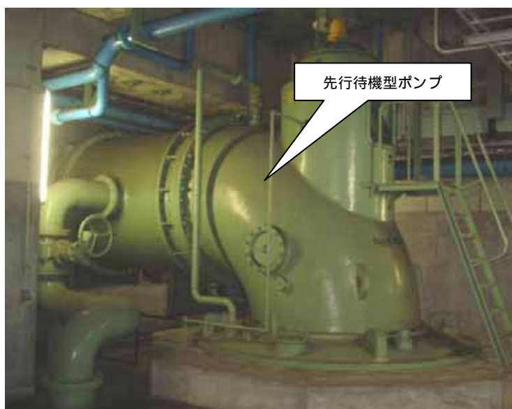
図 1 - 1 0 先行待機型ポンプ 資料：仙台市
