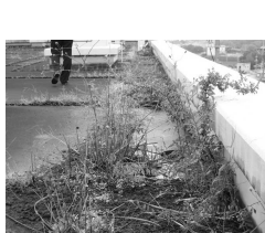
屋上目地部の雑草
