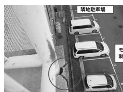
屋外階段手すり部の異常
