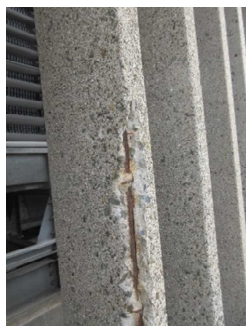
外壁コンクリートの剥落
