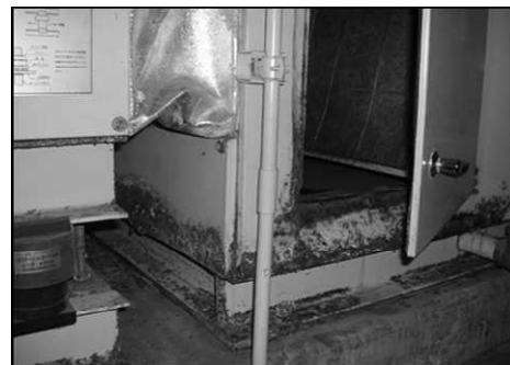
ユニット形空調機の腐食
