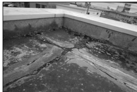
防水押さえコンクリートの損傷
