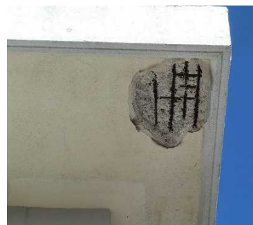
庇コンクリートの剥落
