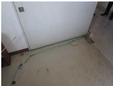
防火扉の開閉範囲に通信ケーブルを設置
