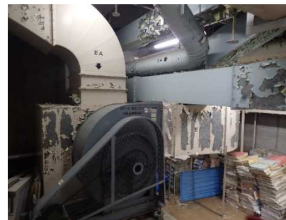
機械室に置かれた可燃物
