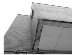
外壁タイルの異常
