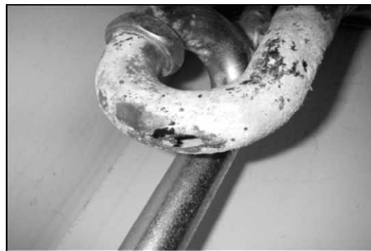
排水トラップの腐食
