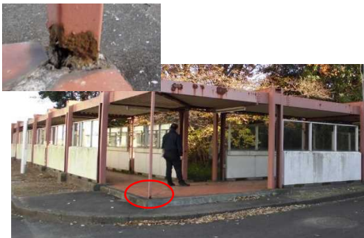
渡り廊下支柱の腐食
