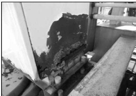
屋外制御盤のさび
