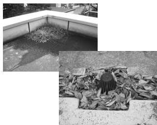
ルーフトレンの清掃不良
