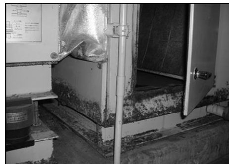
ユニット形空調機の腐食
