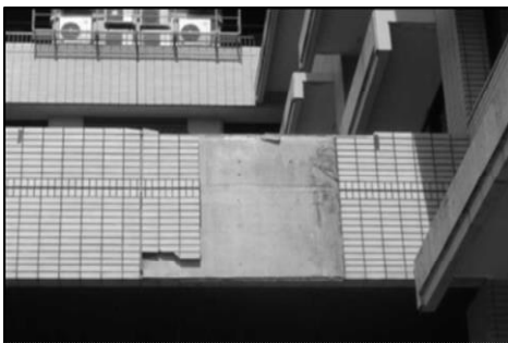
外壁タイルの落下
