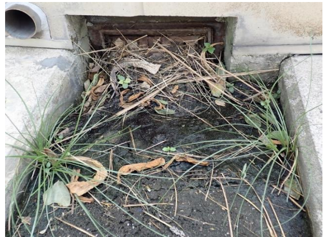
土砂堆積の状況
