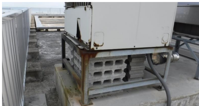
腐食した屋外機下に設置したコンクリートブロック
