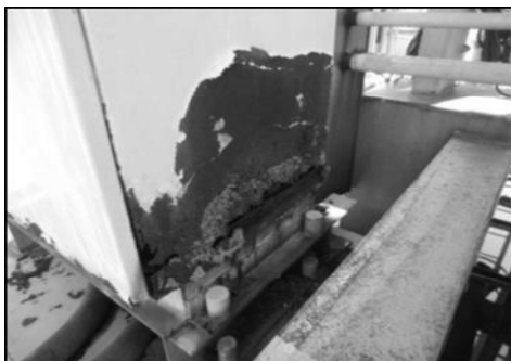
屋外制御盤のさび
