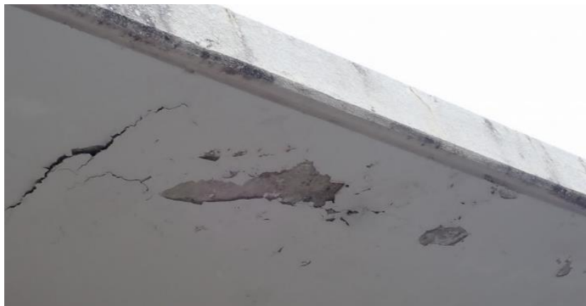
軒裏コンクリートの剥落
