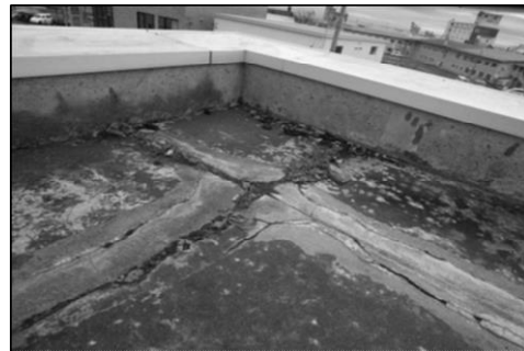
防水押さえコンクリートの損傷
