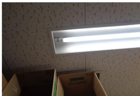
ランプのみ直管型LEDに交換されている照明器具
