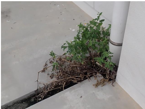
雑草繁茂の状況
