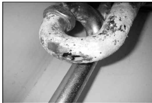
排水トラップの腐食
