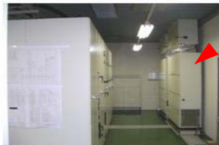
電気室冷却用パッケージ空調機
