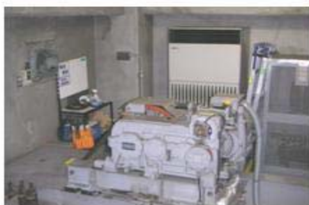
エレベーター機械室冷却用パッケージ空調機
