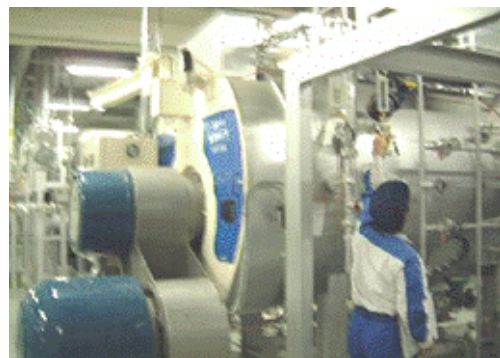
冷凍機の定期点検
