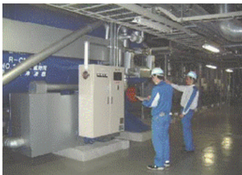
ボイラーの定期点検
