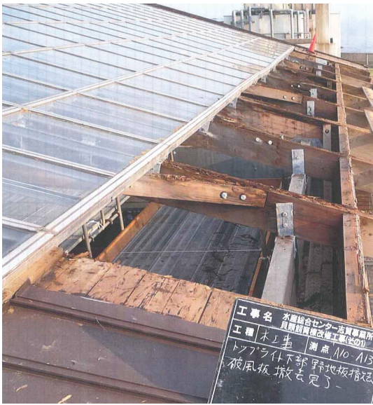
集成材腐食状況
