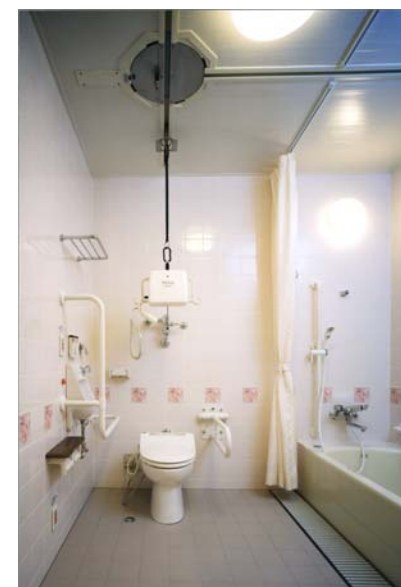
◀介護リフトを設けた身障者対応トイレ
