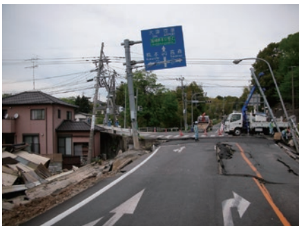
図表6 大規模路面陥没の復旧(国道443号の被災状況)
