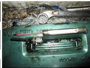
主機潤滑油冷却器下で発見された温度計、ケース枠及び感温外筒
