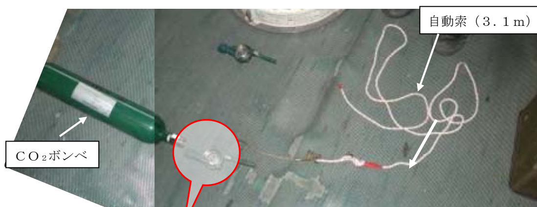
[自動索とCO 2 ポンベの接続状況]
