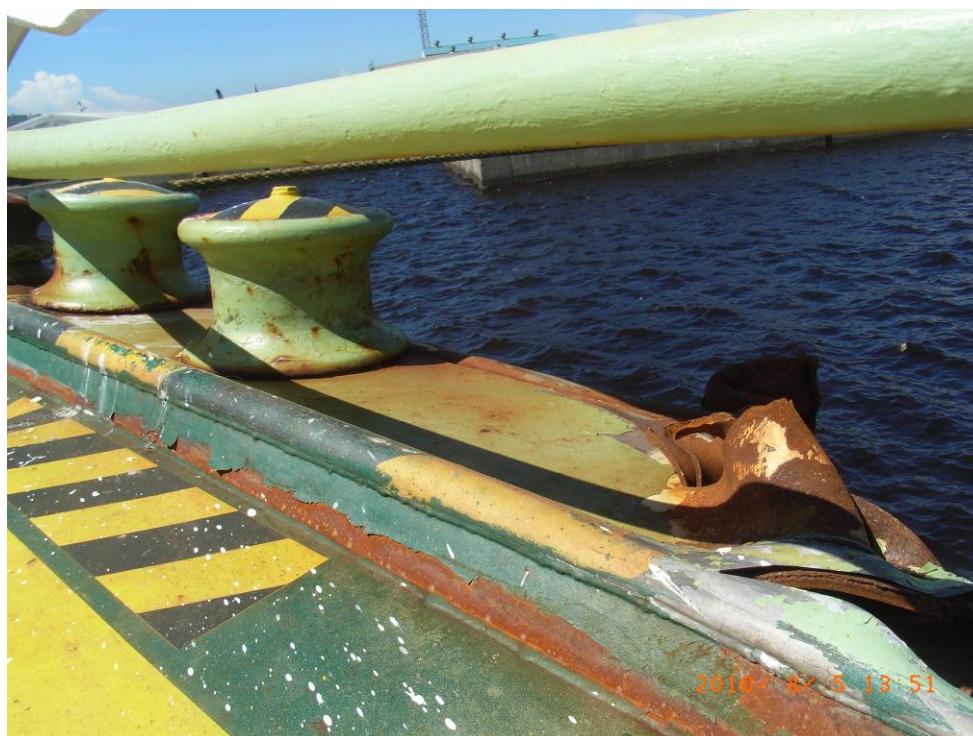
写真 9 B 船の損傷状況（前部その 2）
