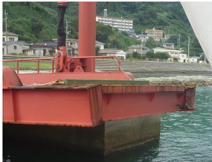
写真2 可動橋の損傷状況（桁の曲損）
