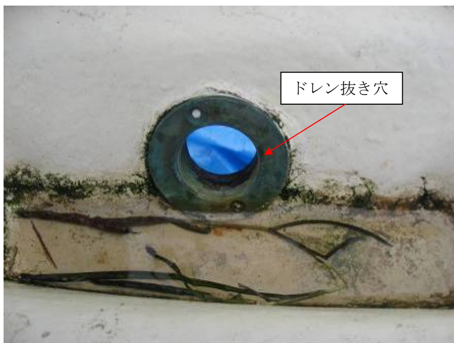
写真8 ドレン抜き穴（左舷側）の状況
