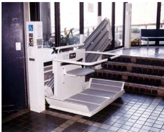
・既存施設のホール部分の階段に設置した斜行型階段昇降機の例
