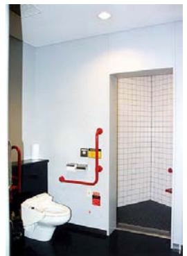
L シャワー付多機能便房 一階S1エントランスに設置
