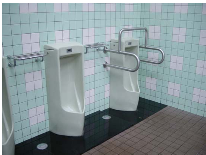
C 手すり、荷物台付の小便器
