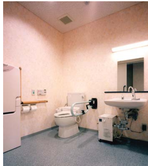
F 多機能便房 折たたみ式の乳幼児用ベッドが設置されている。
