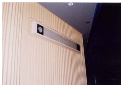
C 多目的ホールの文字表示板
