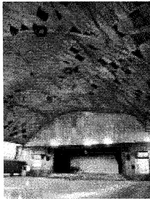
天井材の落下
