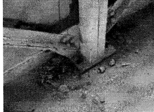
間柱脚部アンカーボルト破断
