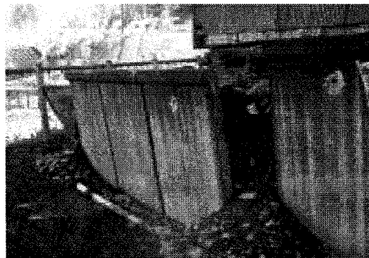
宅地擁壁の被害
