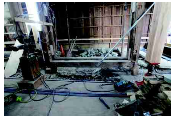
劣化基礎を取り除いたところ（基礎劣化のためやり替え）
