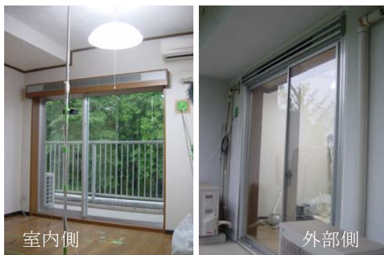
図1 ハイブリッド換気システムの設置状況
