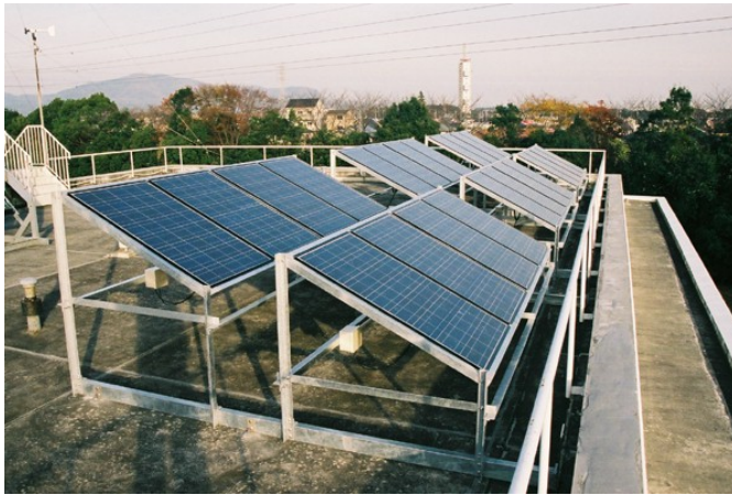
写真1 検証用太陽光発電装置（定格出力3 kWh）
