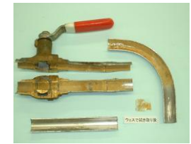
施工後27年経過の冷温水配管 (表面粗度 Ra=2.2μ)
