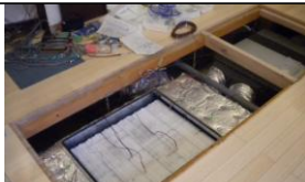
蓄熱空調機設置状況(図3)
