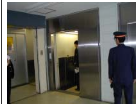
増設された荷物専用EV
