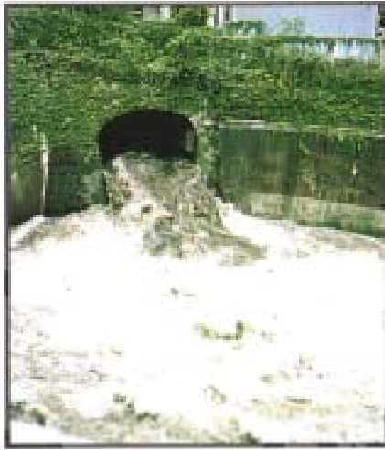
（雨天時の未処理下水放流状況）
