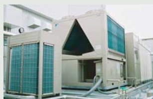
■水蓄熱ユニット （広島運輸支局）
