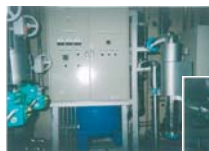
■雨水処理装置制御盤
