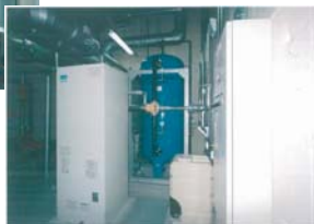
■雨水ろ過装置
