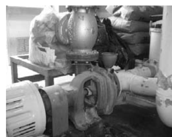
図3-1-3 ポンプのさび
