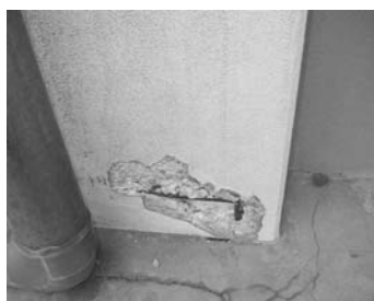
図3-1-2 コンクリート剥離
