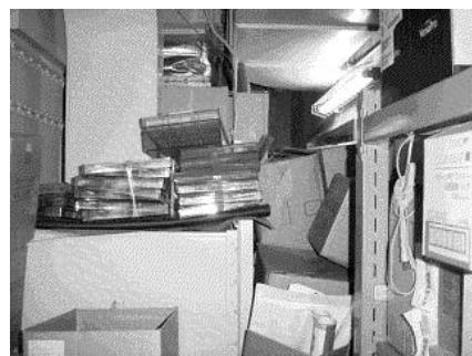
図3-1-18設備室内に可燃物の設置
