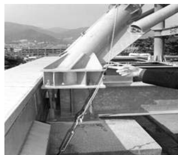
図3-1-12 鉄塔架台のターン バックルのゆるみ
