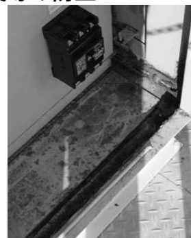
図3-1-16受変電設備の腐食
