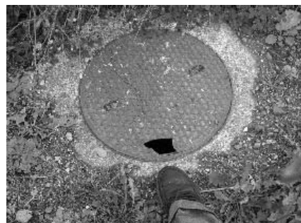
図3-1-19マンホール蓋の劣化
