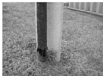
図3-1-20電気配管の経年劣化
