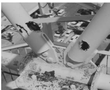
図3-1-11 鉄塔構造部の腐食
