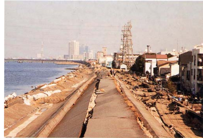
平成7年兵庫県南部地震 淀川
