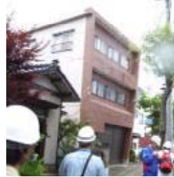
大きく傾いた鉄骨造建築物
