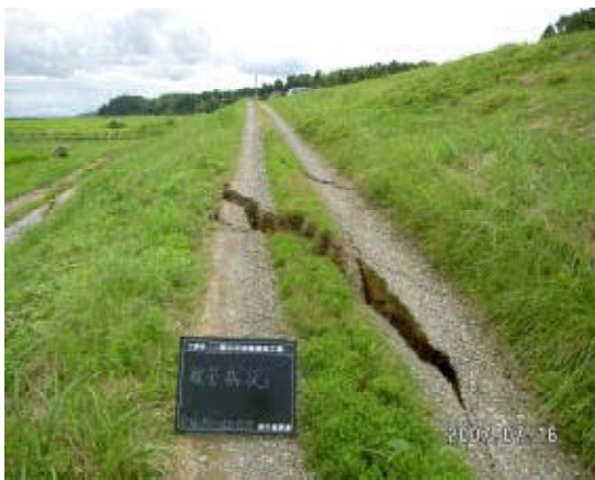
堤防川裏小段のクラック 信濃川本川左岸(長岡市町軽井)
