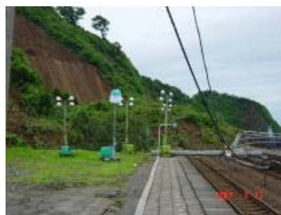
青海川駅付近の土砂流入
