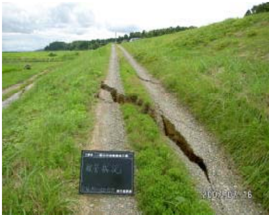
堤防川裏小段のクラック 信濃川本川左岸（長岡市町軽井）
