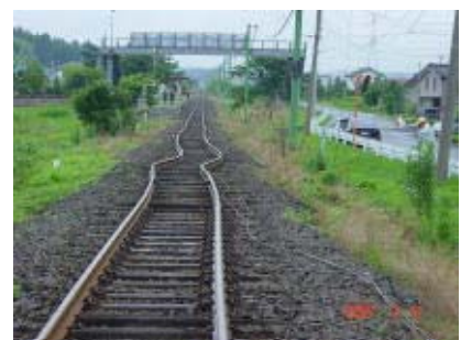
荒浜駅付近のレールの変状
