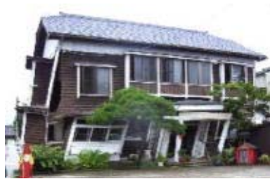
残留変形が大きい木造建築物
