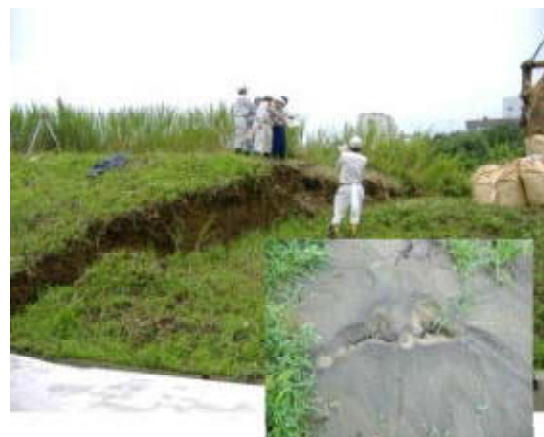
堤防の沈下と液状化による噴砂跡 鯖石川左岸(柏崎市橋場町)
