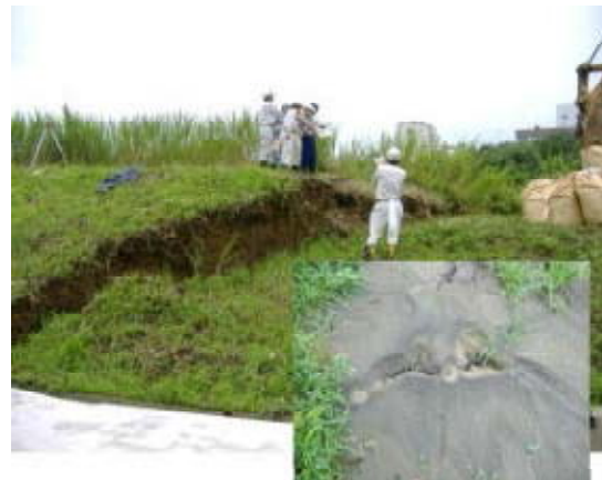
堤防の沈下と液状化による噴砂跡 鯖石川左岸（柏崎市橋場町）
