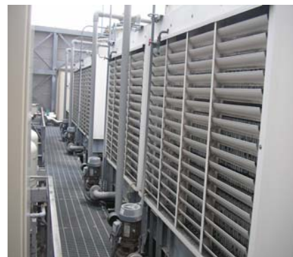
〈冷却塔の清掃・管理〉
