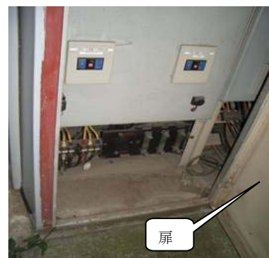
〈配電盤扉の開閉不良〉
