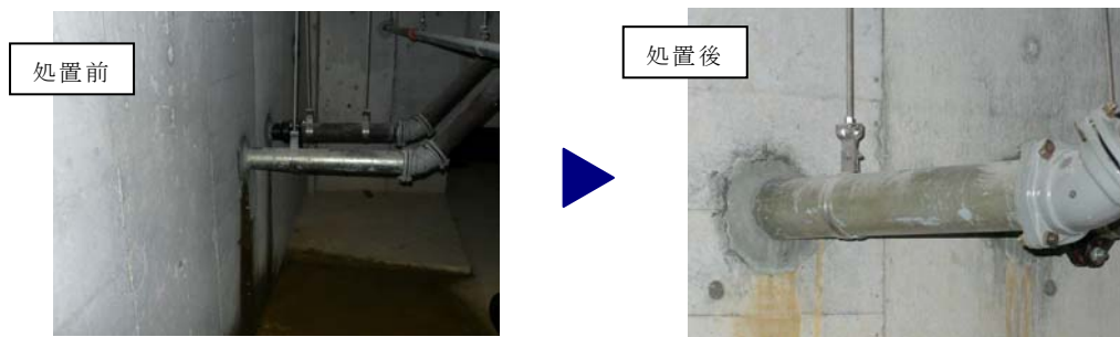
〈地下ピット内の漏水〉
