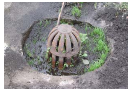
＜ルーフドレンの詰まり＞
