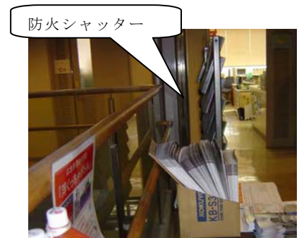
〈防火シャッター下部の支障物〉
