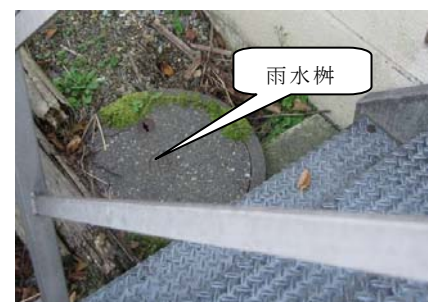
＜屋外階段と雨水枥の干渉＞
