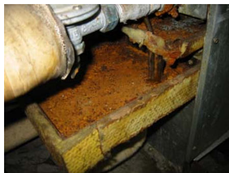
〈ドレンパンの錆の発生〉
