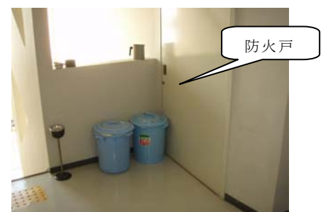
〈防火戸横の支障物〉
