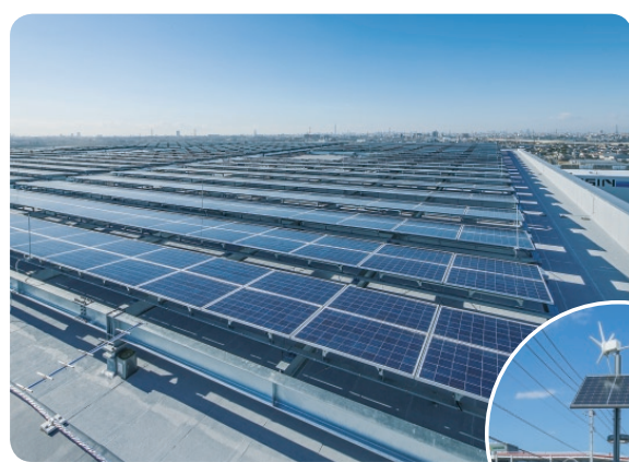
屋上に設置された太陽光発電設備
