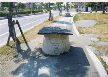
液状化による マンホールの浮上
