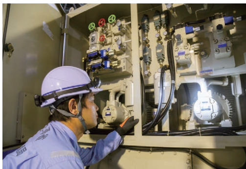
機器の異常をいち早く察知するには、正常な状態を知っておくことがとても重要。
