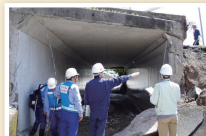
道路施設の被害状況調査(益城町)
