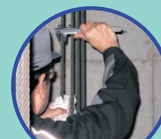
エレベーターの主索検査
