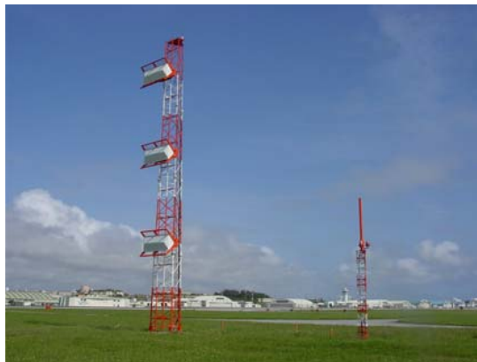
ILS グライドパスアンテナとターミナルDMEアンテナ
