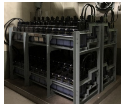
蓄電池設備 (開放式の設置例)
