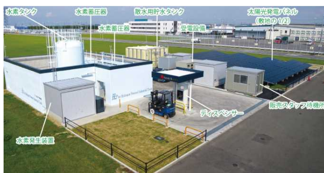
写真 5.2.3 中部国際空港 貨物地区水素充填所 (オンサイト方式)
