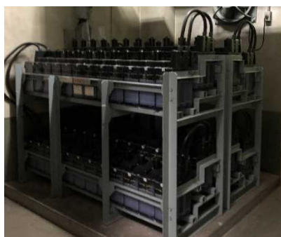
写真 5.3.3 蓄電池設備 (開放式の設置例)
