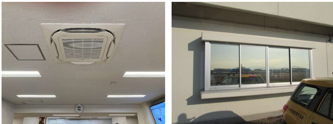
図 4-5 空調設備、遮光フィルムを貼った窓ガラス
