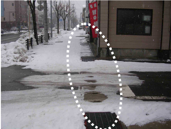
写真 3 - 11 流雪溝の整備位置の様子
