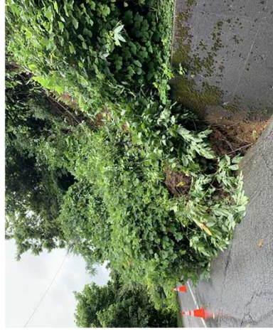
【被災状況写真】
