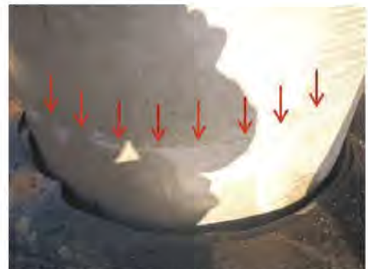
付録写真-2.4 PHC杭に発生したクラック
