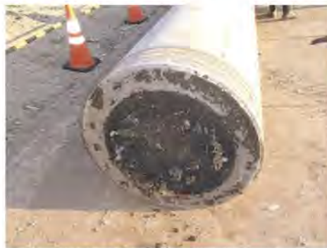
付録写真-2.5 杭内部の閉塞状態
