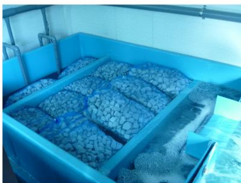
▲浄化槽の様子
