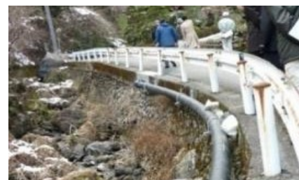
クイック配管(露出配管)
