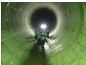
雨水貯留管(東京都)
