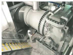
雨水ポンプ(広島市)
