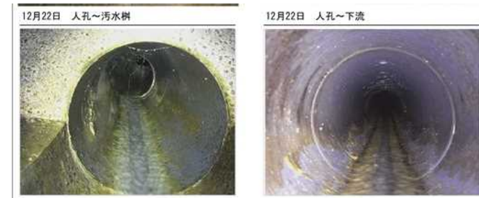
豊田市、公共人孔上下流 (介護施設②)
