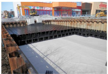
雨水貯留施設 （地下貯留）
