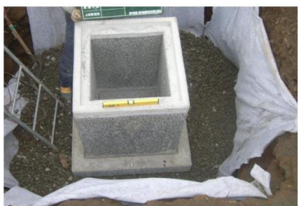
雨水浸透施設 （浸透ます）
