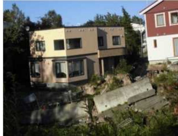
建物倒壊（北広島市）
