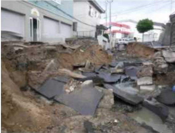
道路損壊（札幌市清田区）
