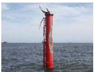
船舶接触事故後 (灯標の上部脱落)
