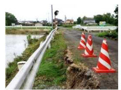
クリーク法面崩壊
